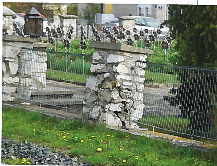
Der beschädigte Friedhofspfeiler am Soldatenfriedhof Völkermarkt-St. Ruprecht
